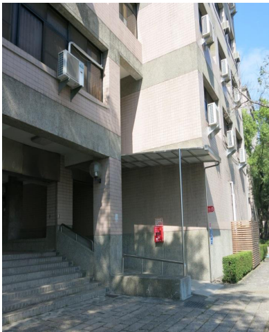
屏商校區教學貳館一樓 東側入口牆壁
